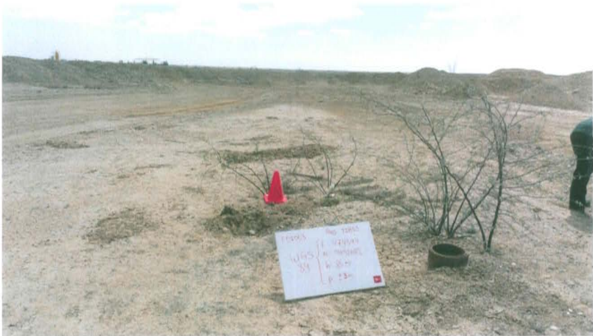
Fotografía N° 1. Vista de ubicación del pozo donde se observa el pozo con el casing y brida en estado de deterioro y abierto.
