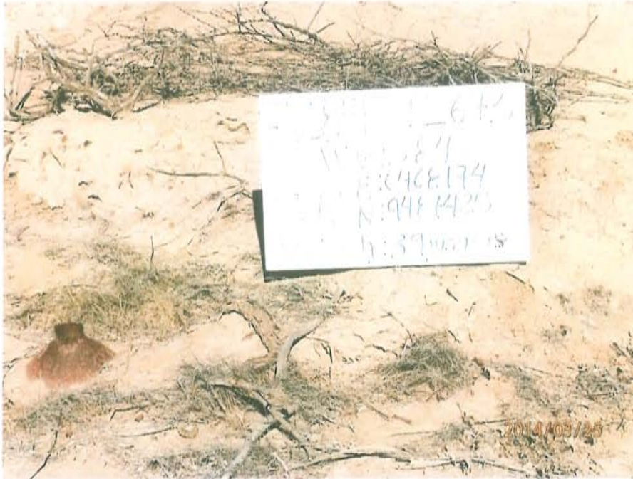
Fotografía N° 1. Se observa casing del pozo T_673 de 8 plg de diámetro unido a una tubería de reducción de 2 plg de diámetro, abierto sin cabezal ni accesorios que aseguren su hermetismo.
