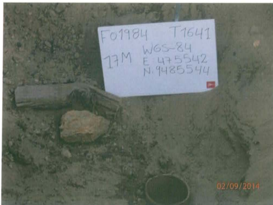
Fotografía N° 2. Se observa pozo inactivo que presenta una casing el cual se encuentra abierto, sin elemento de cierre tales como válvulas, llaves entre otros, que garantizan un cierre hermético del pozo.
