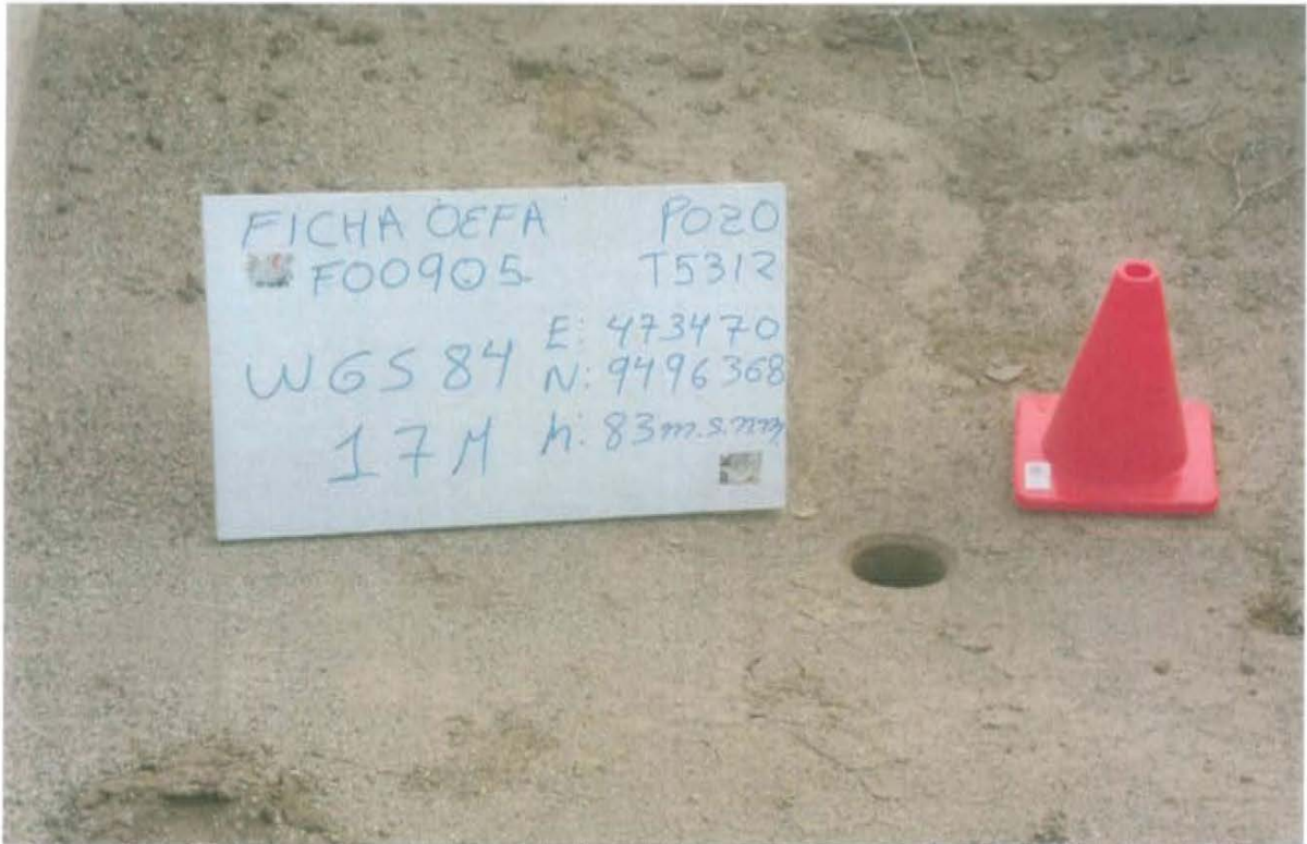
Fotografía N° 01.- Pozo con código PERUPETRO T5312 y con código Ficha OEFA F00905, se muestra el pozo a nivel de suelo sin cabezal o con alguna válvula, por lo que se encuentra expuesto al ambiente.
