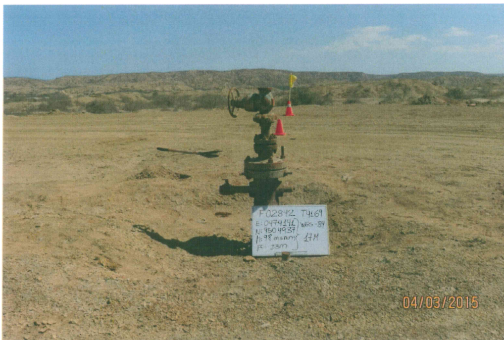
Fotografía N° 1. Se observa el Pozo T4169, el cual está compuesto por un arreglo de tuberías, dos (2) bridas concéntricas y dos (2) válvulas laterales con claros signos de corrosión, lo cual no garantiza el hermetismo del pozo.
