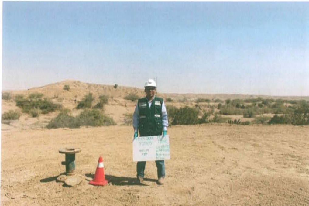
Fotografía N° 2. Se observa casing unido a la parte inferior de la brida y encuentra abierta como expuesta al ambiente.
