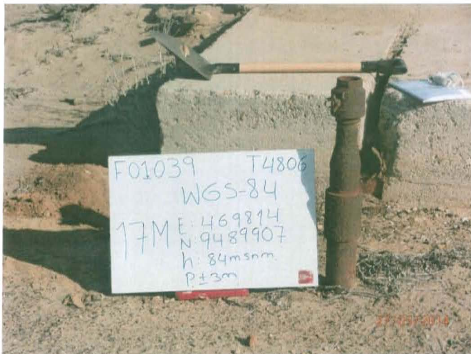
Fotografía N° 2. Coordenadas de ubicación del pozo T4806, donde se observa una tubería de reducción con válvula corroida, cuyo estado no garantiza el hermetismo del pozo.
