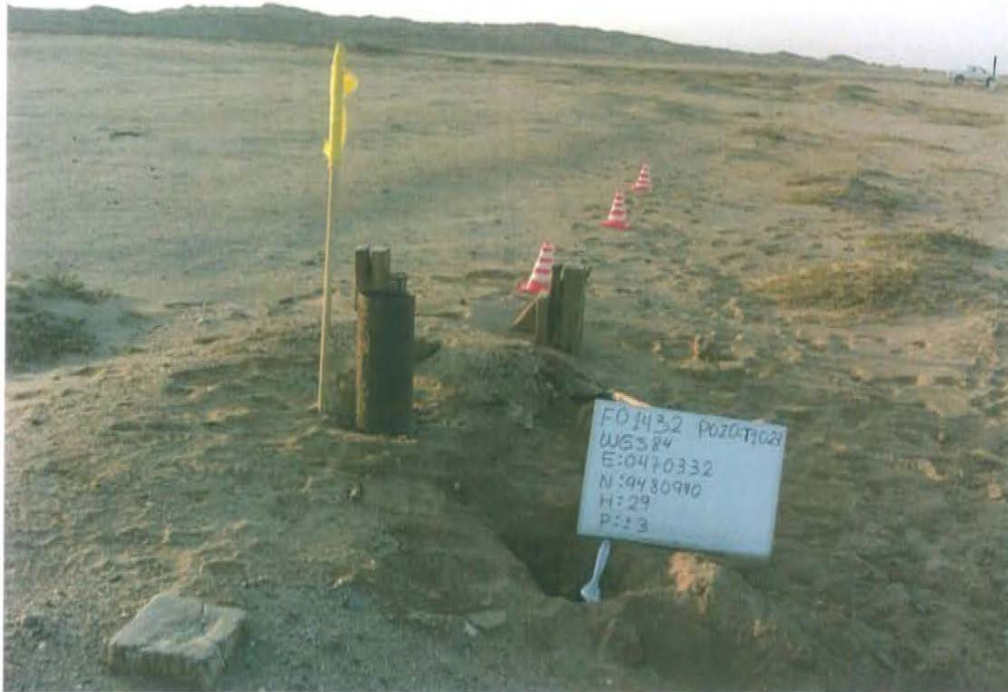
Fotografía N° 1. Pozo mal abandonado con casing corroído perteneciente a la Ficha F01432.
