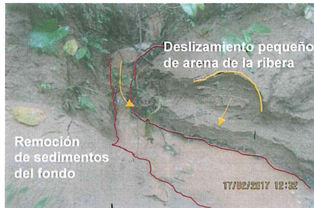
Fotografía 11-1. Erosión fluvial de una pequeña quebrada tributaria al río Macuya
