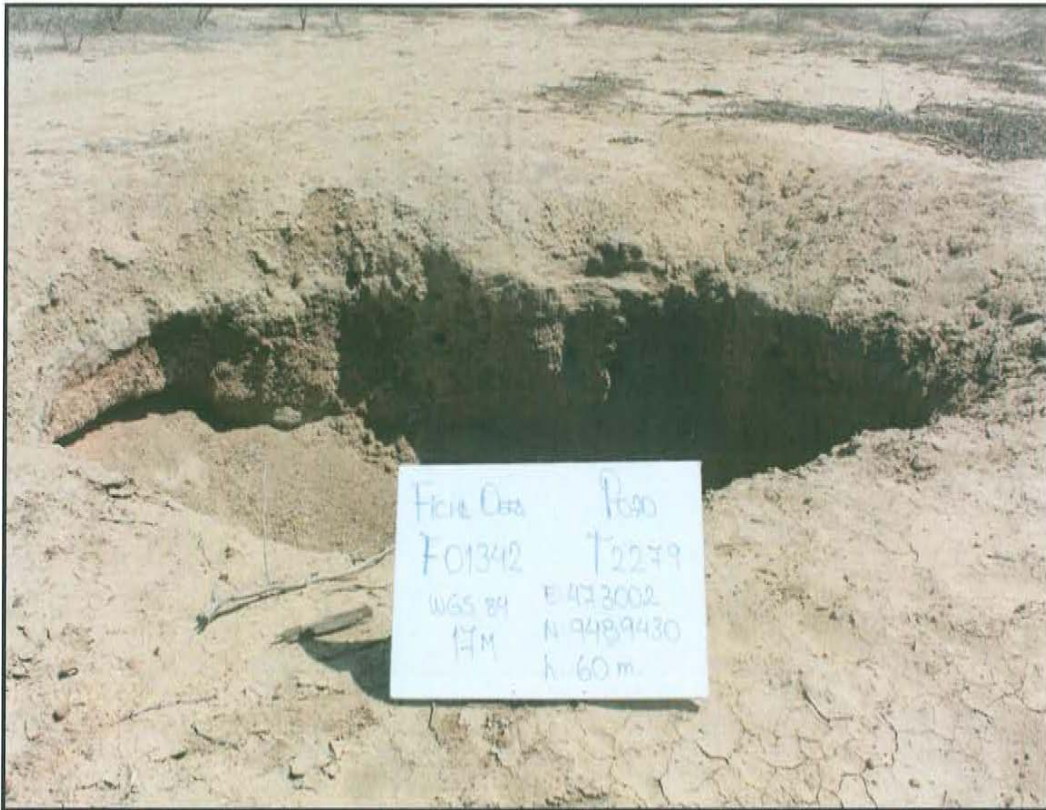
Fotografía N° 1. Pozo T 2279 presenta casing abierto de 10 plg con una altura de 0,2 m desde la base del hoyo de 2,1 m de profundidad.
