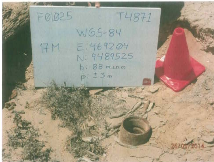
Fotografía N° 1. Pozo inactivo, se observa el casing cortado sin cabezal ni válvula que asegure su hermetismo, por lo cual se encuentra abierto al ambiente.
