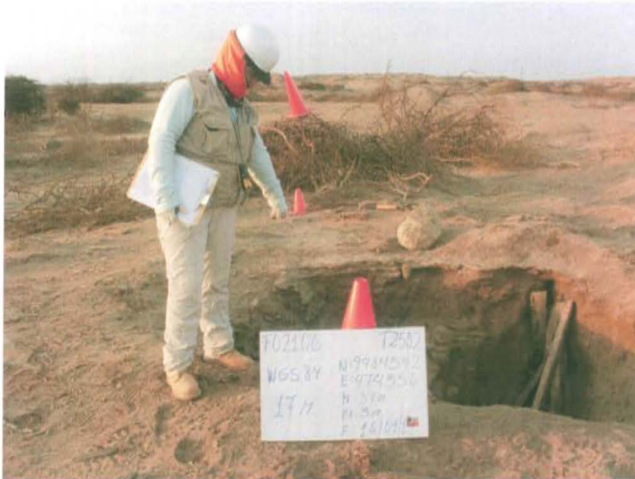
Fotografía N° 1. Ubicación del pozo inactivo, en el interior de una excavación con casing con brida expuesto al ambiente.
