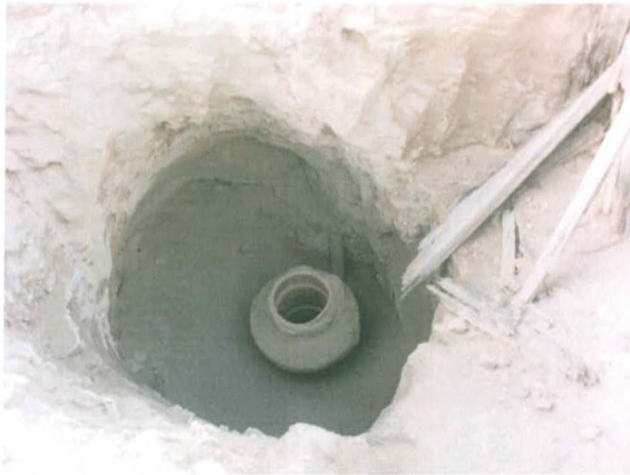
Fotografía N° 2. Se observa que el pozo presenta casing con brida el cual se encuentra abierto, sin elemento de cierre tales como válvulas, llaves entre otros, que garanticen un cierre hermético del pozo.
