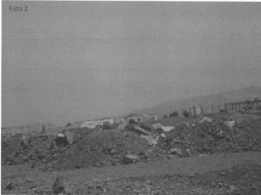
Fotografía N° 2. Evidencia de arrojado de residuos sólidos de construcción, en el punto georeferenciado N° 1, del Cuadro N°1, Nótese las grandes acumulaciones de residuos. Coordenadas UTM WGS 84 (18L 0285067E 8648057N)
