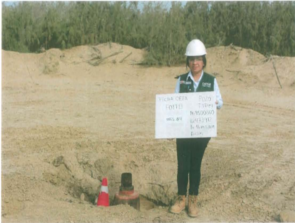
Fotografía N° 1. Pozo T3749 perteneciente a la ficha F01713, de 13,4" de diámetro y de 0,13 m de altura sobre el nivel del suelo, acoplado con un tubo reductor pero sin accesorios que aseguren su hermetismo por lo que se le consideró abierto al ambiente.
