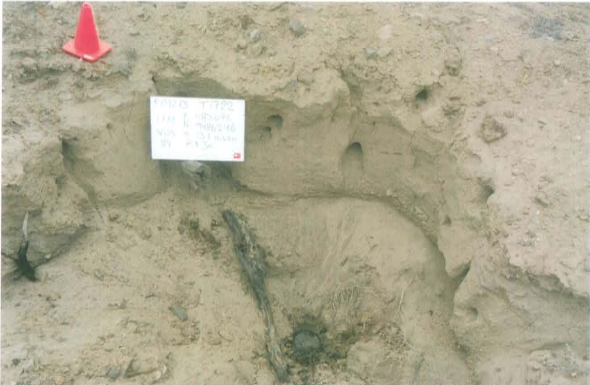
Fotografía N° 01.- Pozo con código PERUPETRO T1722 con Ficha OEFA F01213, se observa el casing a nivel de la superficie del suelo que no cuenta con cabezal o alguna válvula de cierre por lo que se encontraría abierto al ambiente.
