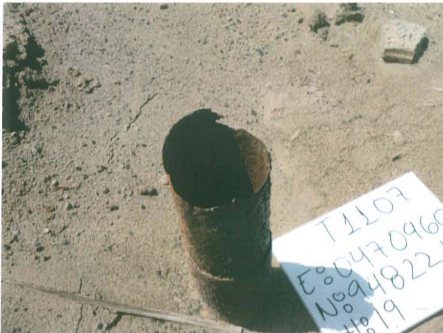
Fotografía N° 4. El casing de revestimiento en la parte superior presenta avanzado estado de corrosión.
