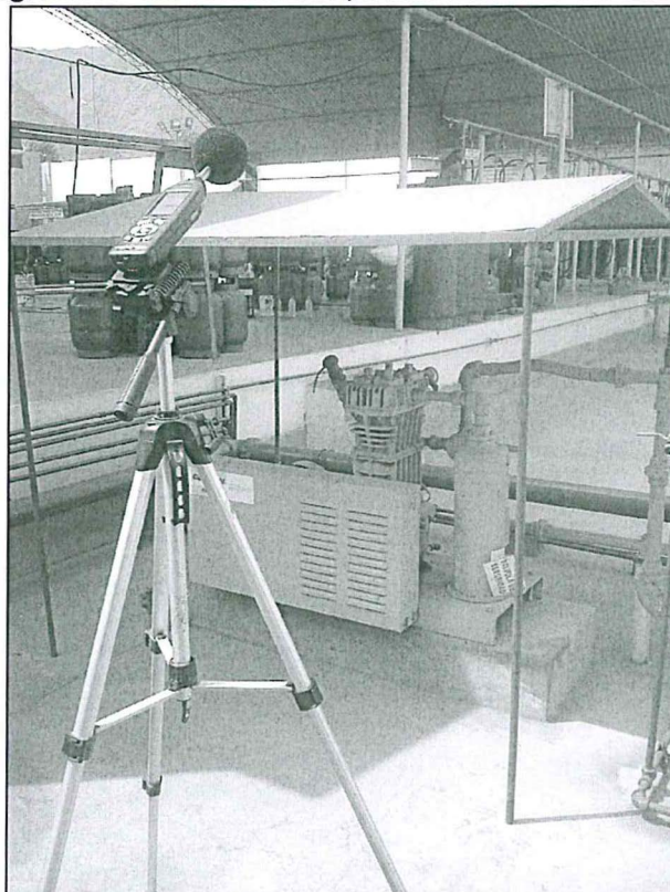
Fotografía N° 02: R-ANTA-02, bomba de GLP de trasiego.
