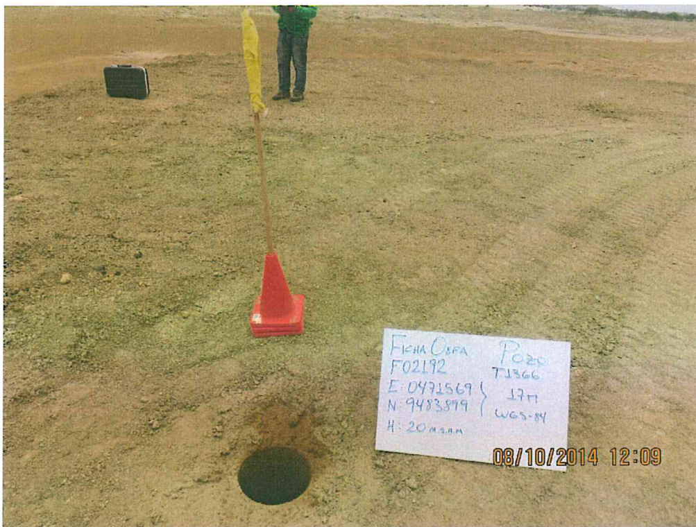
Fotografía N° 1. Vista del pozo T1366, se observa el casing abierto al ambiente.
