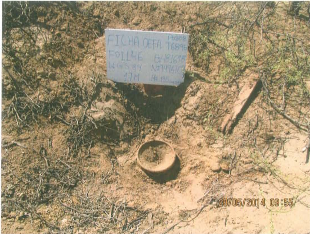
Fotografía N° 1. Casing corroído de 9,5 plg de diámetro con presencia de arena en su interior que se encuentra a nivel de la superficie del suelo.
