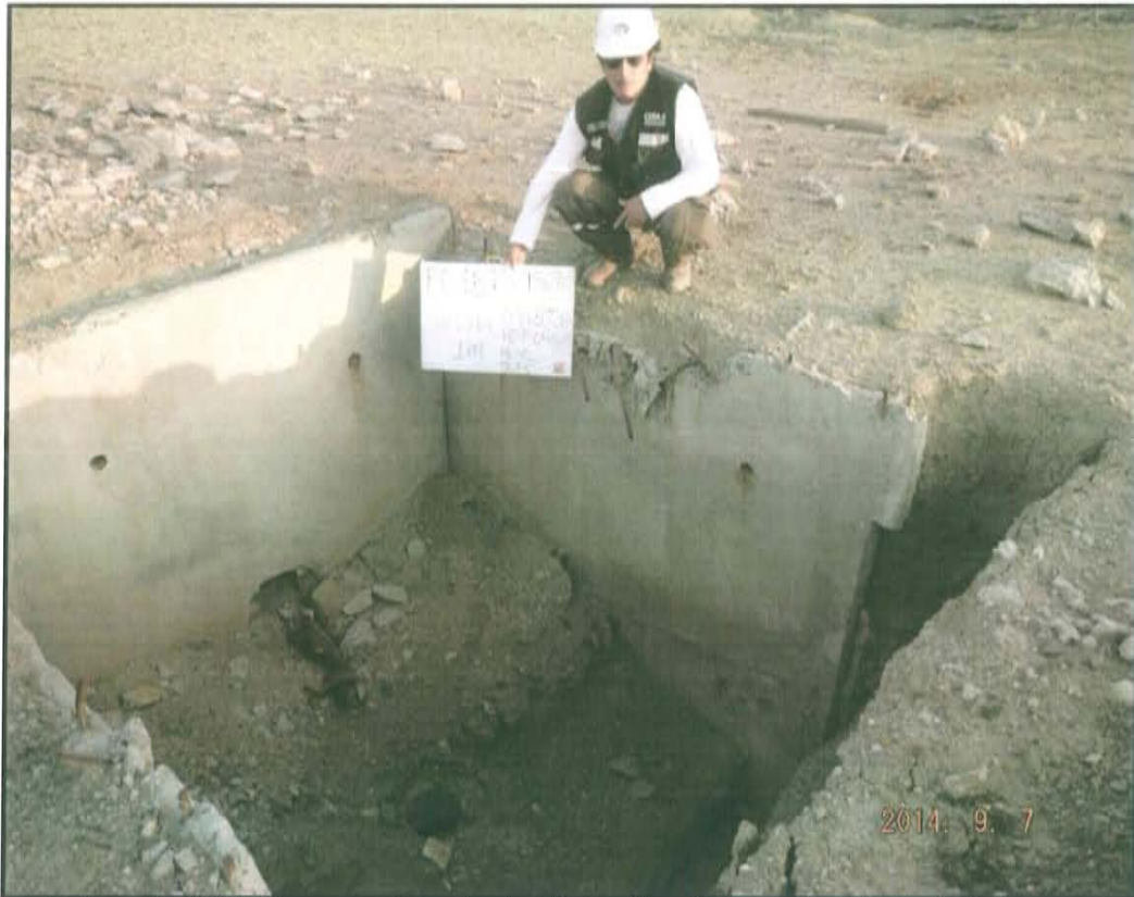
Fotografía N° 1. Pozo inactivo, dentro de cantina de aproximadamente 1,7 m, se aprecia casing a nivel de la base y expuesto al ambiente.
