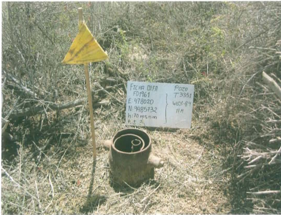
Fotografía N° 1. Se observa el Pozo T3351 con casing cortado, abierto y expuesto al ambiente.
