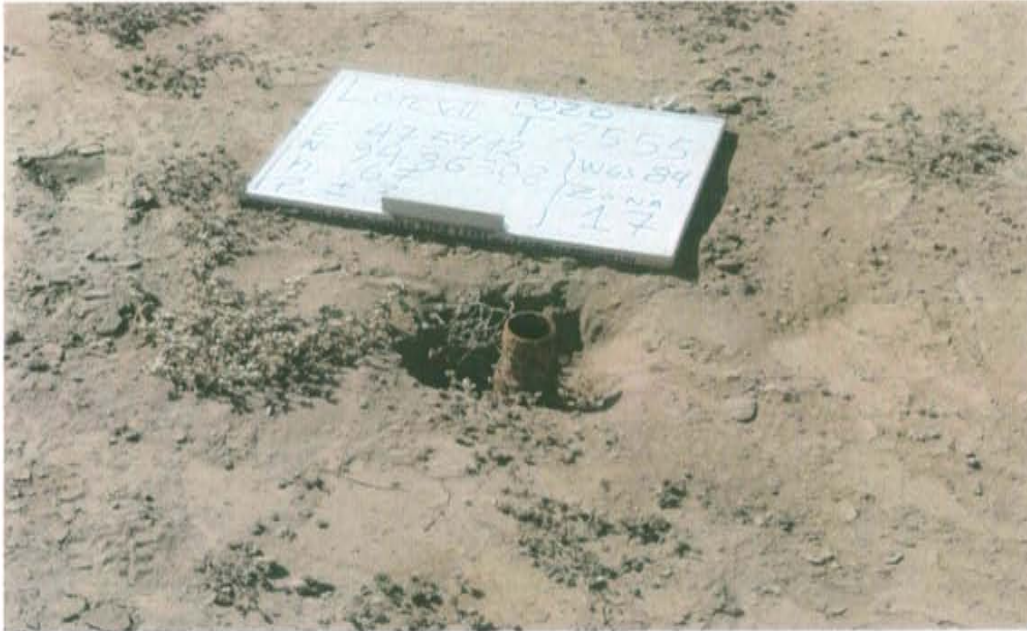
Fotografía N° 1. Se observa el pozo T2555, sin válvula o elemento de cierre, por lo que se considera abierto al ambiente.
