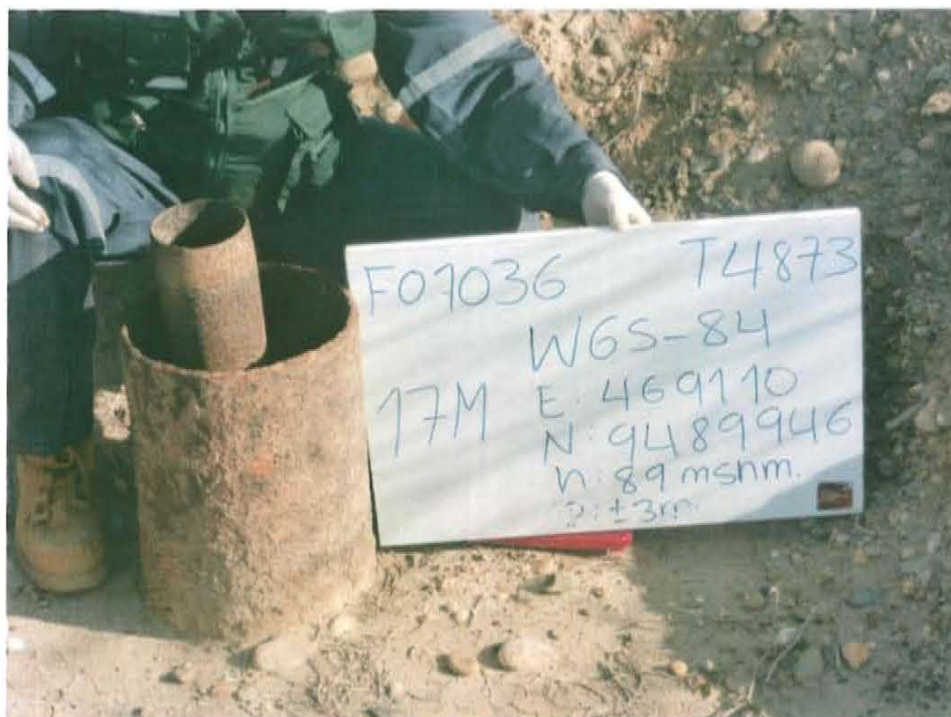
Fotografía N° 2. Se observa un casing de superficie corroído de 8 plg de diámetro que sobresale 0,35 m del nivel superficial y una tubería de 2-1/2 plg de diámetro que sobresale 0,52 m del interior del casing.
