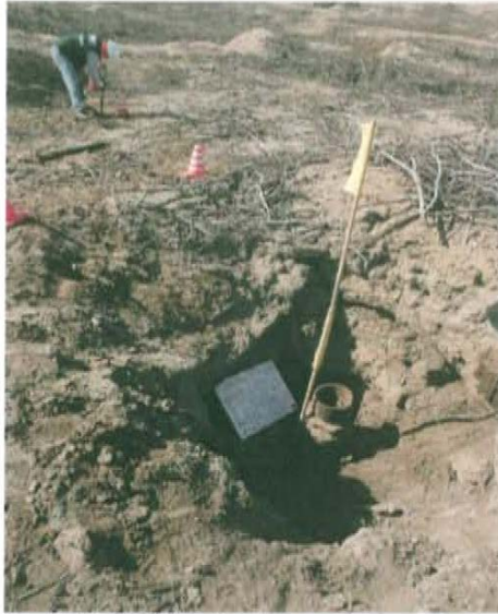
Fotografía N° 1. Se observa pozo inactivo en el interior de una excavación, con casing expuesto al ambiente.
