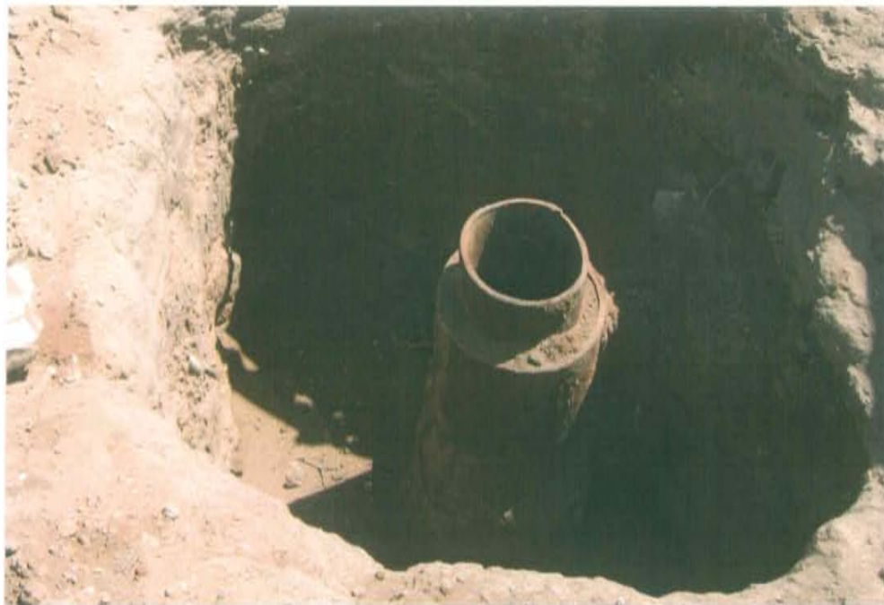
Fotografía N° 3. El Pozo T1810, presenta doble casing ambos cementados en la sección anular y no tienen cabezal ni válvulas que aseguren su hermetismo.
