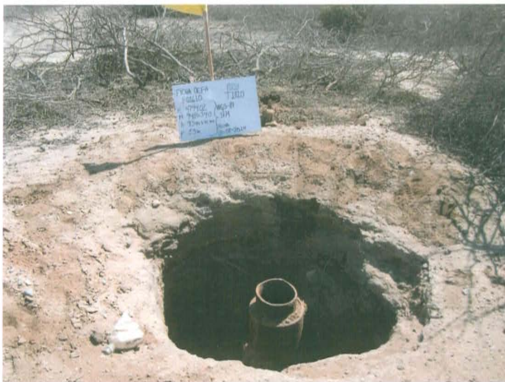
Fotografía N° 1. El Pozo T1810, se encuentra en un hoyo de 1,4 m x 1,2 m x 1,1 m de profundidad abierto y expuesto al ambiente.
