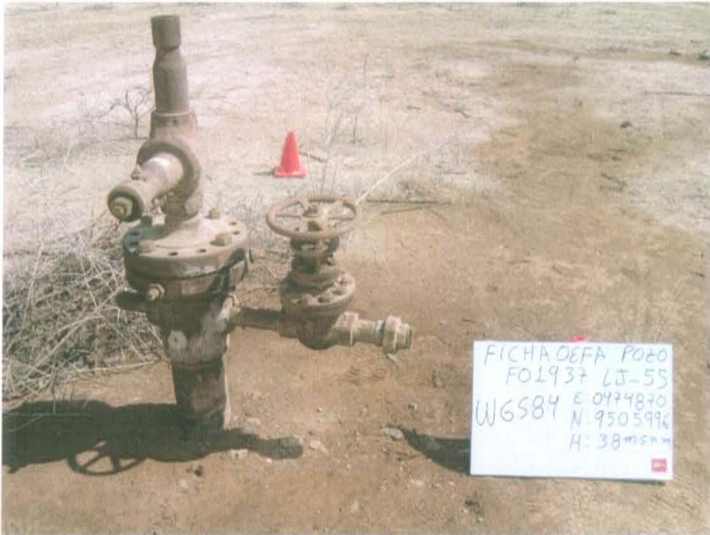
Fotografía N° 1. Identificación del pozo inactivo con código PERUPETRO LJ_55. Presenta cabezal con bridas y válvulas.
