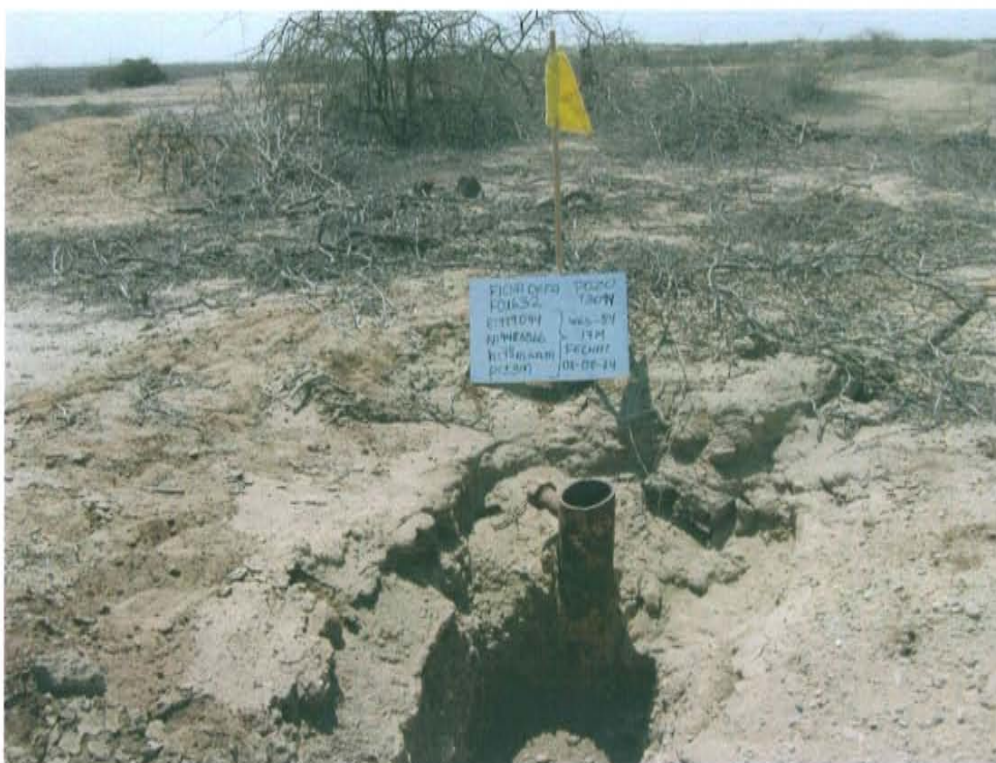
Fotografía N° 1. Pozo inactivo con código PERUPETRO T3094. Se observa casing que sobresale 0,7 m sobre la superficie del suelo.
