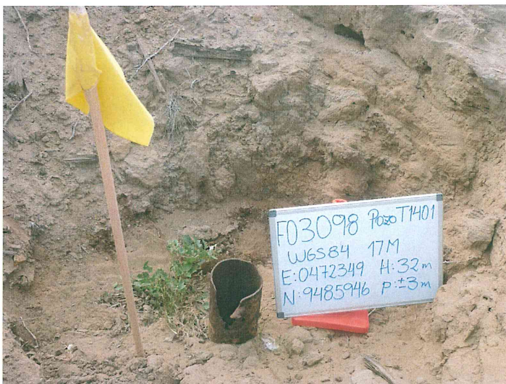
Fotografía N° 1. Vista del pozo T1401 dentro de un hoyo, se observa el casing en estado de corrosión.
