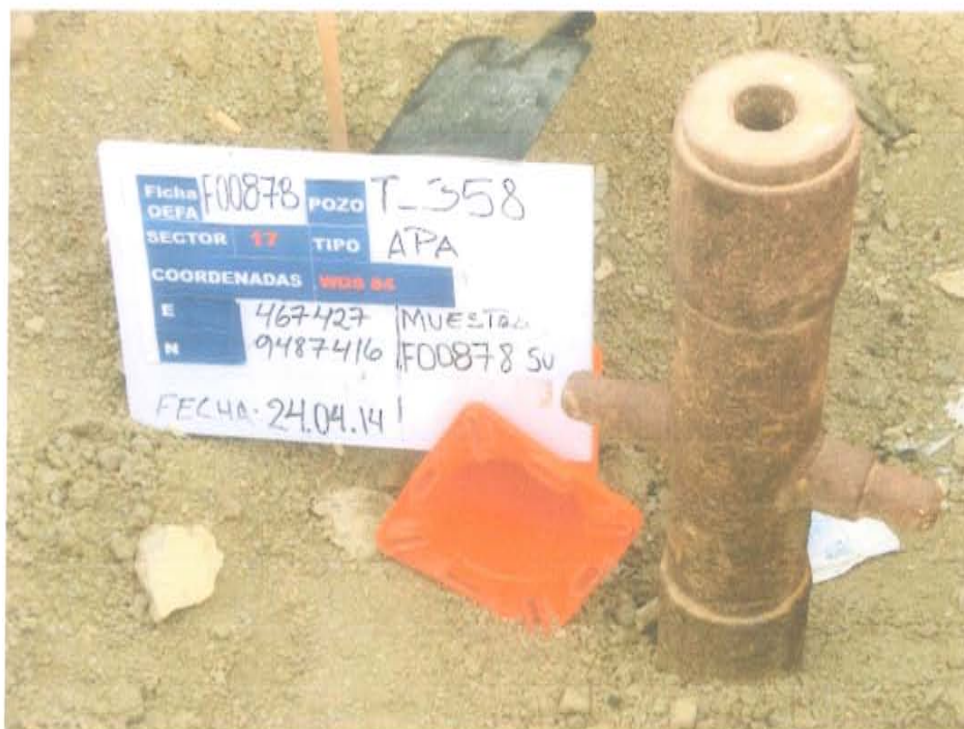
Fotografía N° 1. Pozo T_358 presenta doble casing cementado corroído y abierto.
