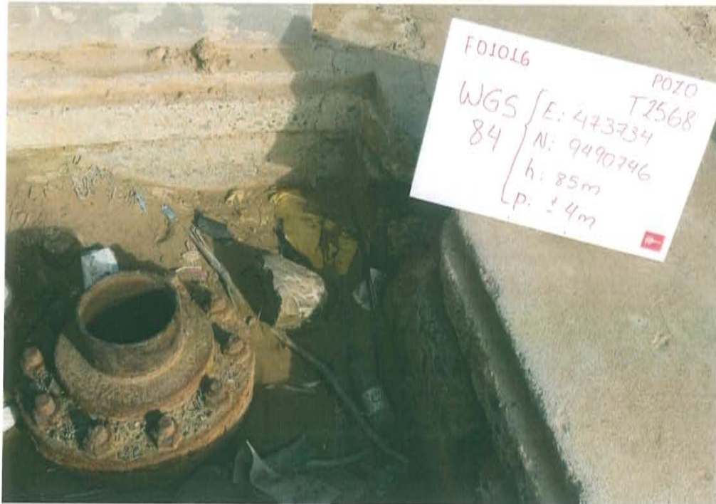
Fotografía N° 1. Identificación del pozo inactivo con código PERUPETRO T2568, con casing a una altura de 0,30 m a nivel del suelo, en estado corrosivo y presencia de la cantina.
