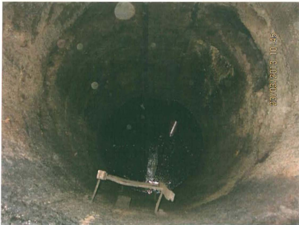
Fotografía N° 2. Se muestra del interior del hoyo donde se ubicaría el pozo R_58 donde se observa la presencia de fluido.
