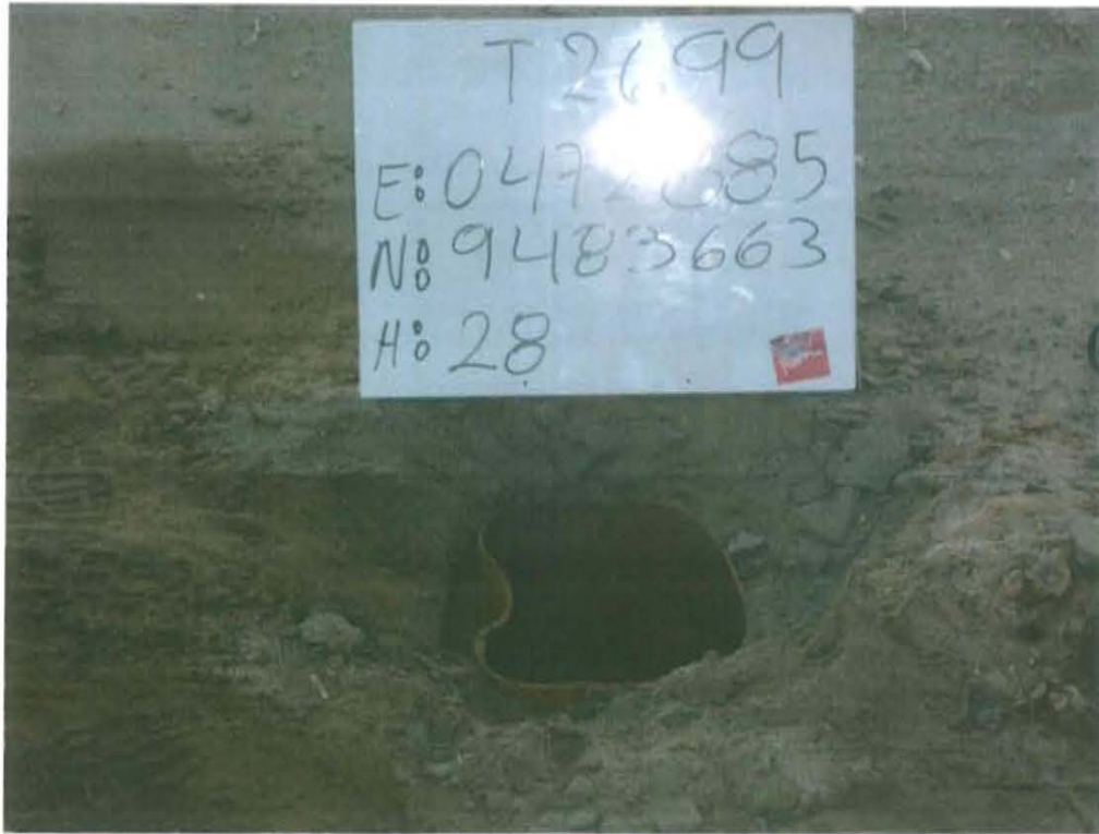
Fotografía N° 1. Pozo inactivo mal abandonado, sin cabezal, con casing abierto al ambiente y a nivel de suelo.
