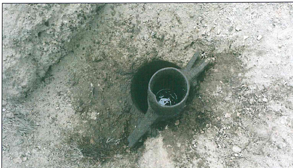
Fotografía N° 3. Se observa el Pozo T2023 con casing abierto, tubo de producción con presencia de posibles hidrocarburos líquidos en su interior.
