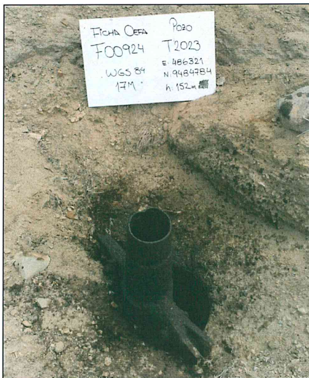
Fotografía N° 1. Se observa el Pozo T2023 con casing abierto con tubo de producción sin cabezal ni válvulas que aseguren su hermetismo.
