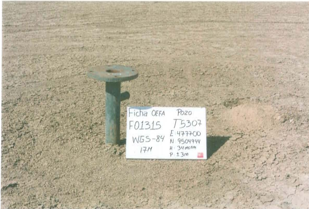
Fotografía N° 1. Identificación del Pozo inactivo con código PERUPETRO T5307. Presenta tubo y brida adaptadora con tubería lateral, expuesta a la intemperie.
