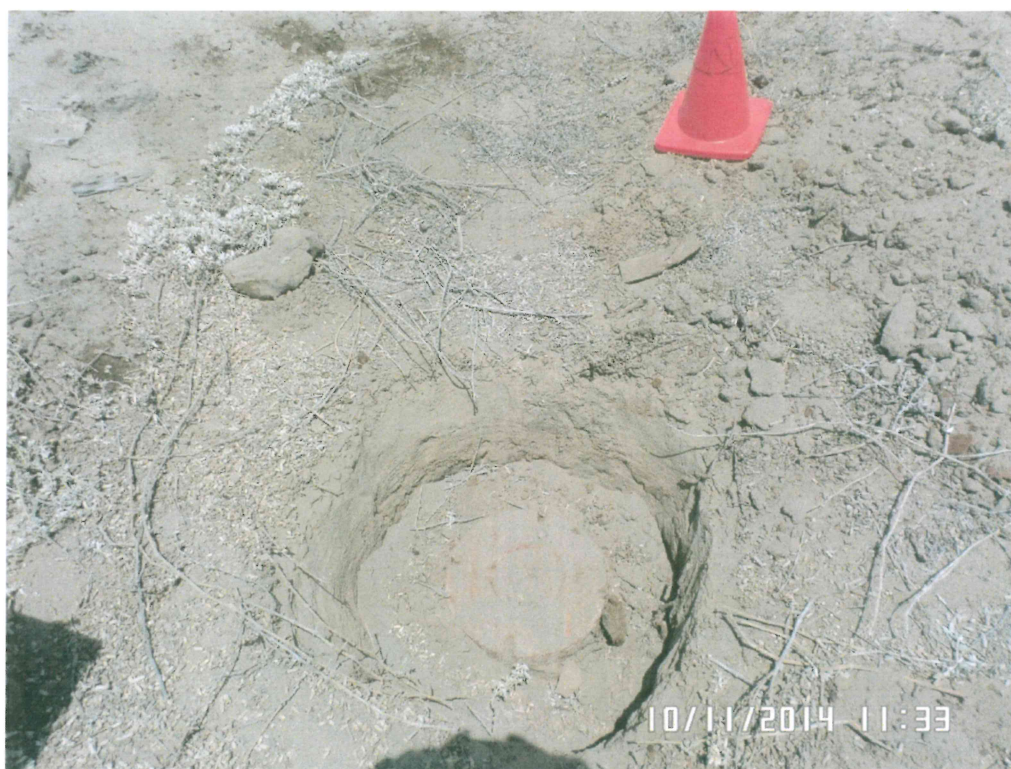
Fotografía N° 1. Vista pozo T3085, se observa el casing corroído y enterrado con suelo con presencia de hidrocarburos.
