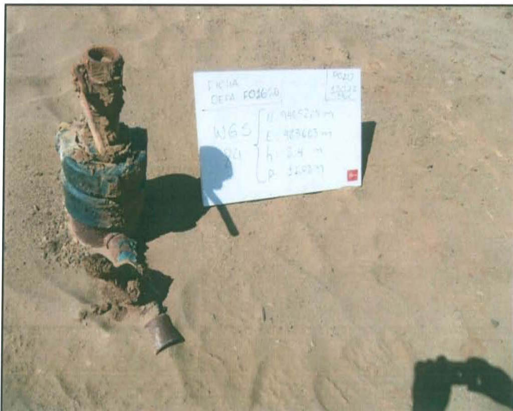
Fotografía N° 2. Cabezal de pozo compuesto por válvulas y tubería de reducción que emerge 0,6 m de la superficie del suelo.
