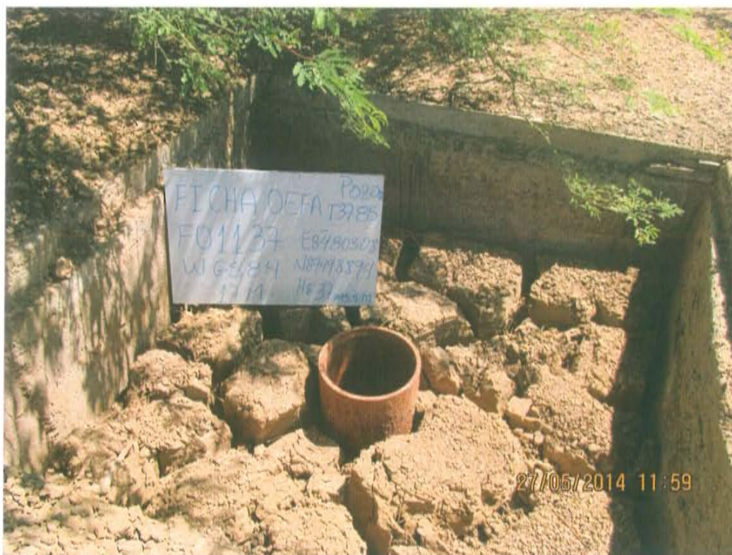
Fotografía N° 1. Se observa casing corroído sin cabezal de aproximadamente de 10,5 plg de diámetro y se encuentra abierto al ambiente.
