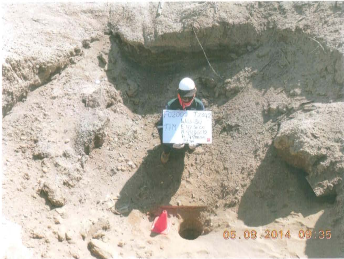
Fotografía N° 1. Identificación del pozo inactivo con código PERUPETRO T2342. Presenta casing abierto y cortado descubierto en el interior de una excavación.
