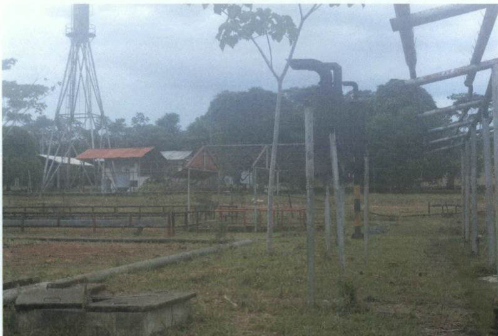
Foto N° 10: La Batería 7 Nueva Esperanza inoperativo y en estado de abandono por más de 10 años. Todos los accesorios y facilidades de producción se encuentra inoperativo y en estado de oxidación.
