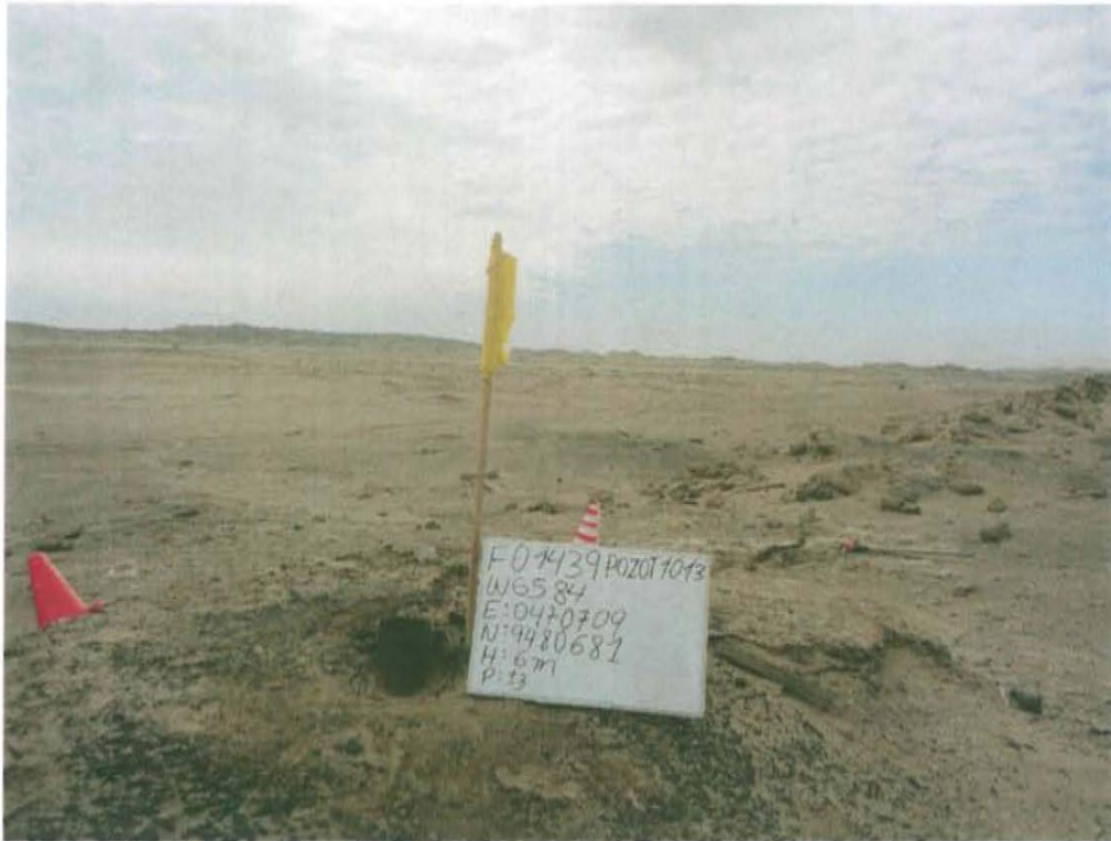
Fotografía N° 1. Pozo mal abandonado con casing corroído perteneciente a la ficha F01013 que sobresale 0,16 m sobre la superficie del suelo.
