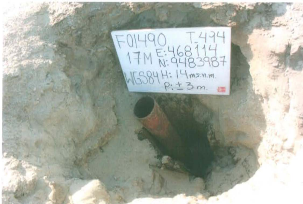
Fotografía N° 1. Pozo T_494, presenta casing cortado y corroído dentro de un hoyo de 0,7 m de profundidad.
