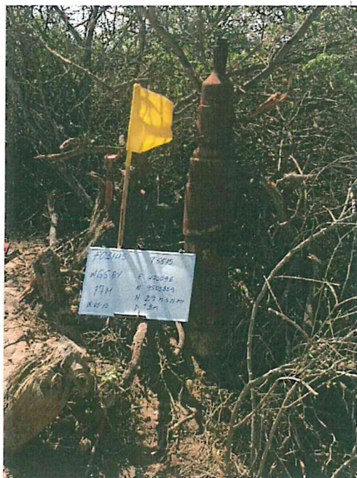
Fotografía N° 2. Pozo T5515, presenta un casing (tubería de revestimiento) expuesto en 1,5 m sobre la superficie del suelo con cabezal tipo embudo invertido y concéntricamente una tubería de reducción de 2 pulgadas de diámetro sin válvulas que aseguren su hermetismo.
