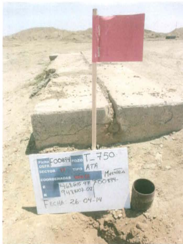
Fotografía N° 1. Pozo T_750, presenta casing abierto cerca de una estructura de concreto.
