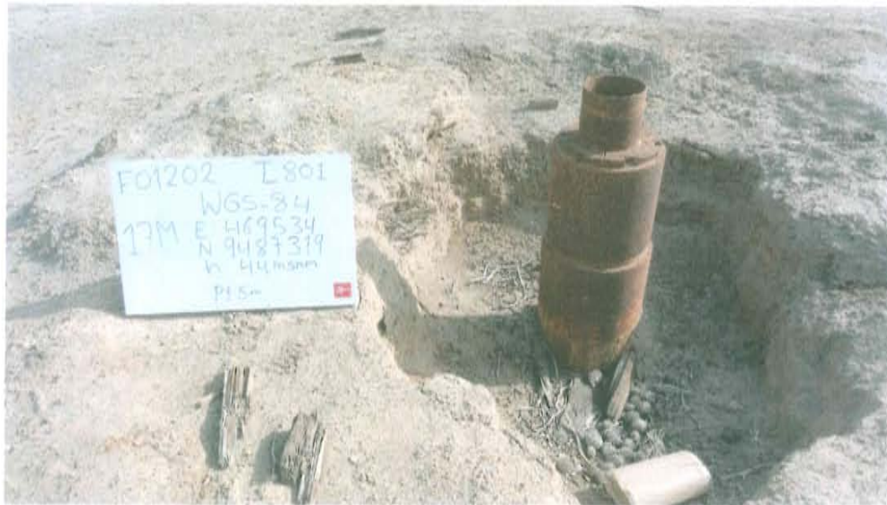
Fotografía N° 1. Vista del Pozo T_801, presenta casing abierto sin válvulas ni cabezal.
