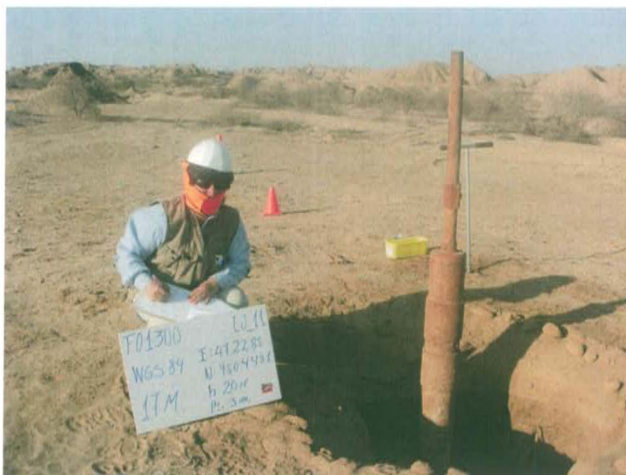
Fotografía N° 2. Pozo LJ_11 ubicado dentro de una cantina de concreto deteriorada y con tubería de producción que sobresale 2,25 m en relación a la base de la cantina.
