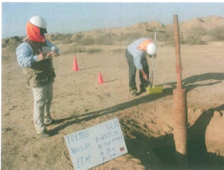
Fotografía N° 1. Pozo LJ_11 sin cabezal y tubería de producción de 3 pulgadas de diámetro abierto y corroído sin elementos de cierre que garanticen su hermeticidad.
