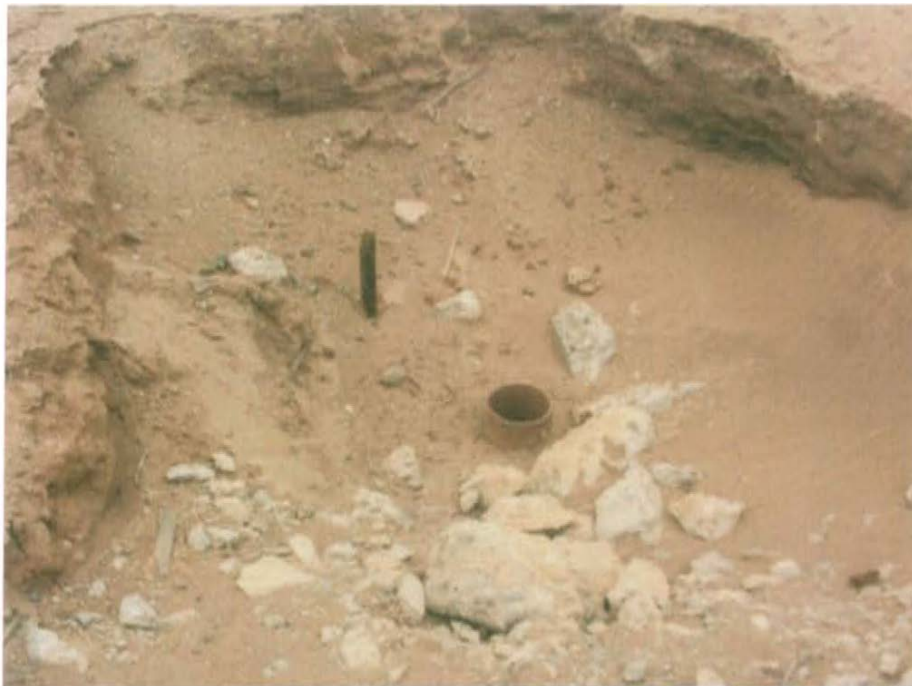
Fotografía N° 2. Se observa que el pozo presenta casing el cual se encuentra abierto, sin elemento de cierre tales como válvulas, llaves entre otros, que garantizan un cierre hermético del pozo.
