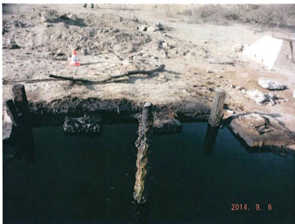
Fotografía N° 3. Pozo presenta impregnación de hidrocarburo en su estructura y se encuentra abierto en la parte superior por donde se observa afloramiento de hidrocarburos y emisiones gaseosas
