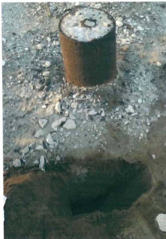
Fotografía N° 3. Vista del pozo T_542, se observa suelo contaminado por hidrocarburos.
