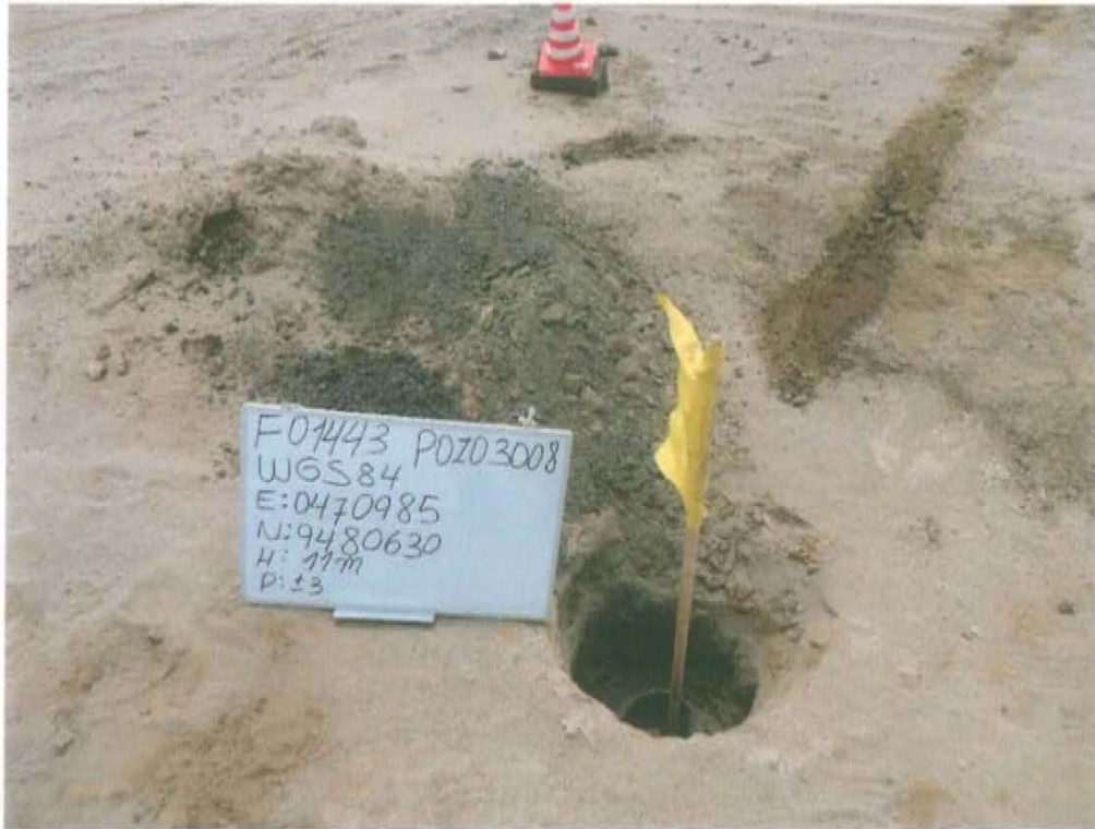
Fotografía N° 1. Pozo T3008, presenta casing corroído que sobresale 0,1 m de altura sobre la superficie del suelo de un hueco de 0,50 m de profundidad, sin tapón, sin brida y sin válvula.
