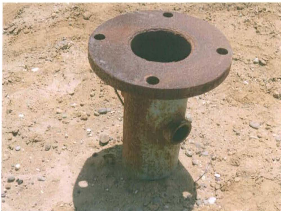
Fotografía N° 2. Se observa pozo inactivo que presenta una casing con brida, el cual se encuentra abierto, sin elemento de cierre tales como válvulas, llaves entre otros, que garanticen un cierre hermético del pozo.
