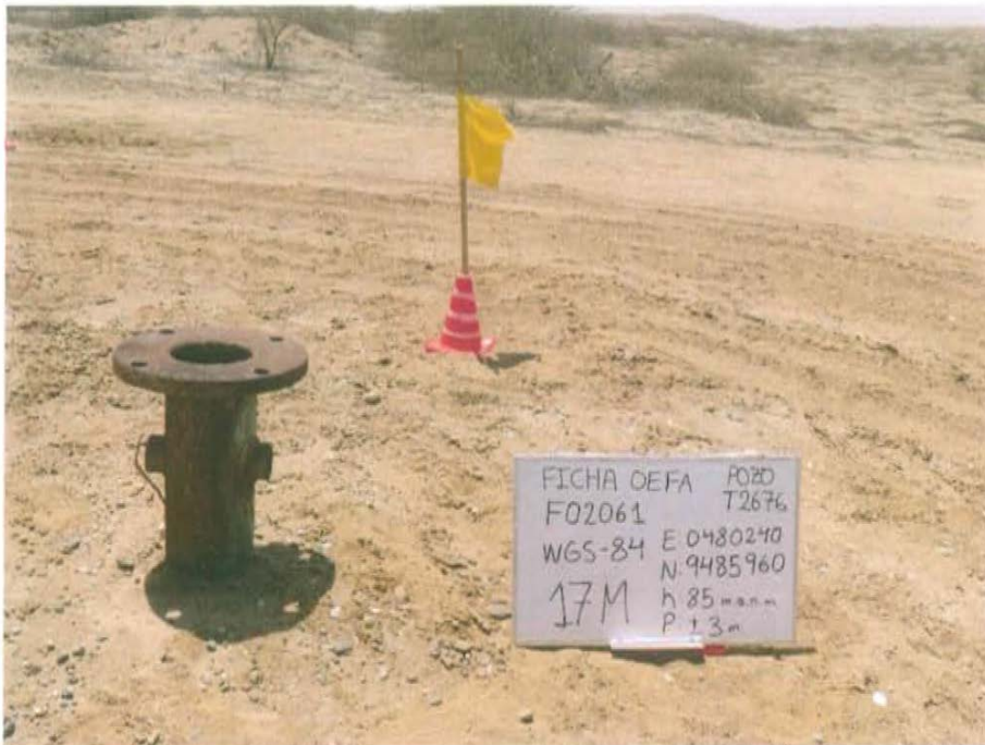
Fotografía N° 1. Ubicación del pozo inactivo ubicado en terreno llano, con casing expuesto al ambiente.
